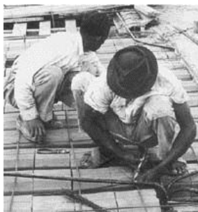
Trabajador de la construcción en Nairobi, Kenia, sin casco ni calzado de protección.
