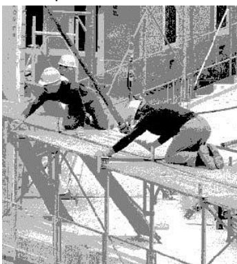
Montaje de andamios en una obra en Ginebra, Suiza, sin las protecciones adecuadas.
